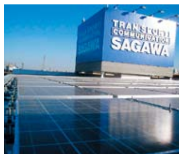
太陽光発電システム
